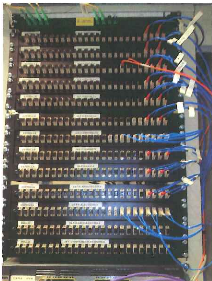
Armario con paneles de fibra
