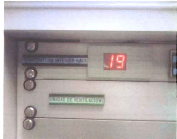
Armario rack Detalle de ventilación y temperatura
